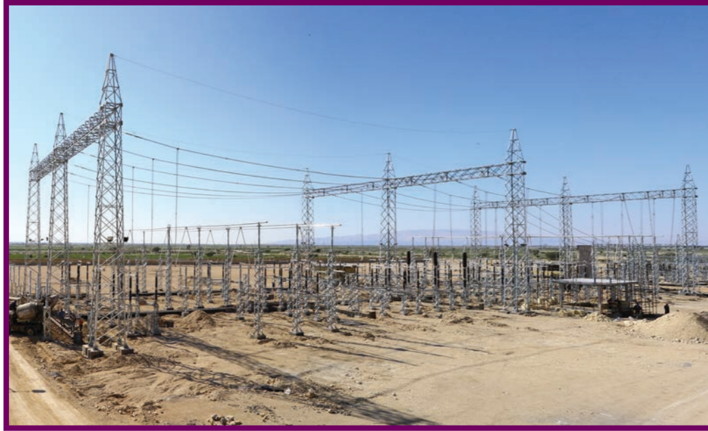
نمایی از پروژه پست برق ۲۳۰/۶۳ کیلوولت بندر خمیر
