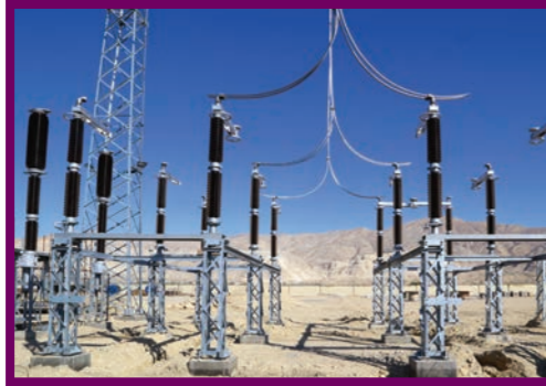
سیم‌کشی هوایی بین تجهیزات ۲۳۰ کیلوولت
