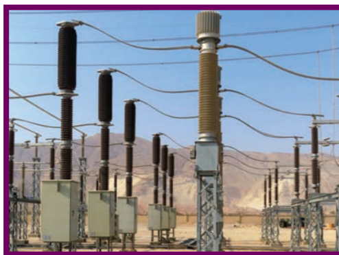
ترانسفورماتور جریان سیلیکونی (CT)
