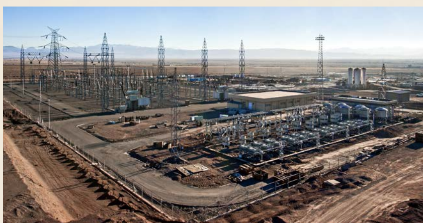
پست برق ۳۳ / ۴۰۰ کیلوولت پروژه فولادسازی بردسیر
