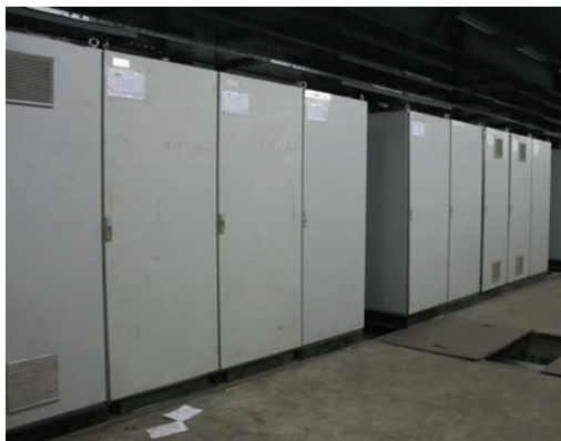
نمایی از تابلوهای کنترل
